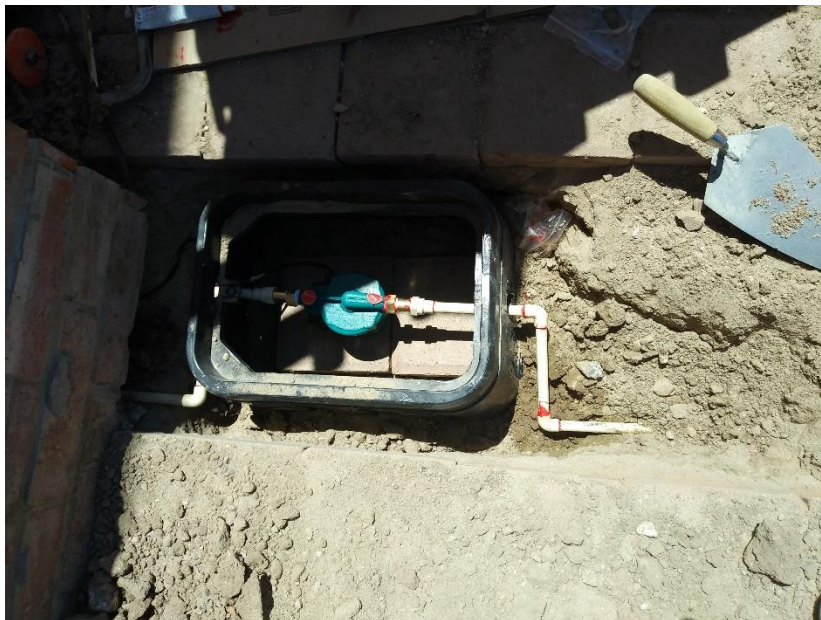
Instalación de bomba neumática para aumentar la presión de agua Julio 2023
